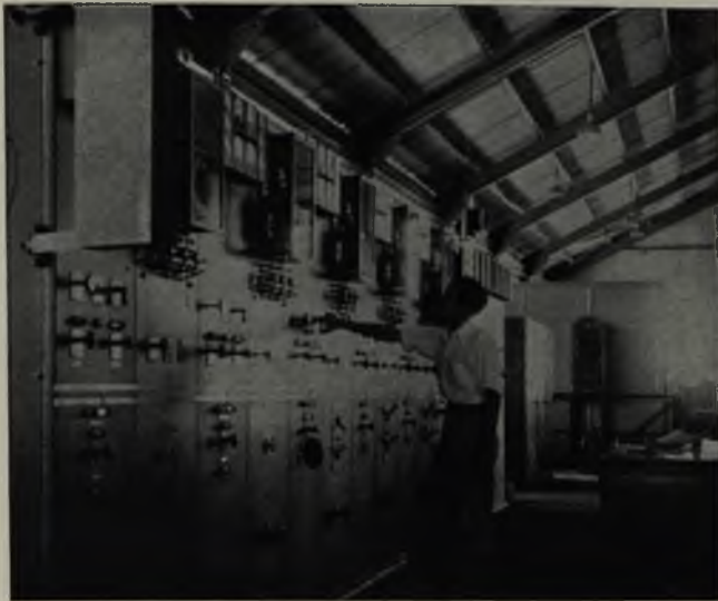
Control eléctrico principal.
