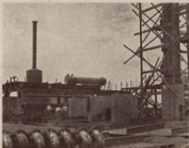
Cámara de control con la torre del estabilizador a la derecha y tambor de drenaje al fondo.
