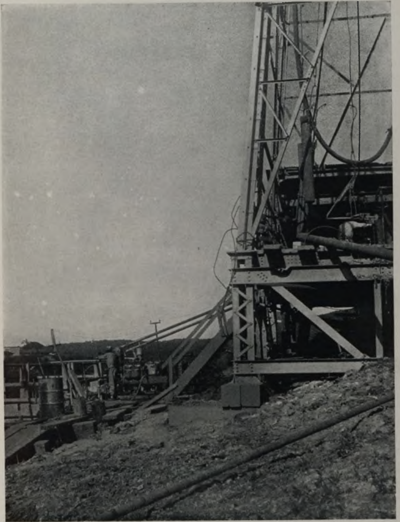
ESMALTES VENEZOLANOS El duro trabajo de un pozo en la amplia región falconiana. (Cortesía del Sr. L. H. Kabla).
