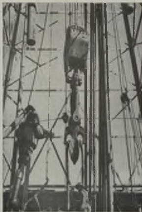
En la imagen se muestra a un trabajador en un pozo petrolero que está perforando. Se ve en el fondo, el campamento y la estructura de acero del pozo donde se está perforando.
