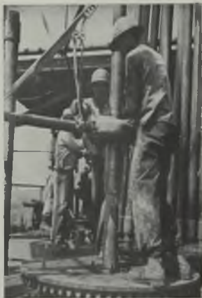
El sitio de perforación en un pozo petrolero. Se ve en el fondo, el campamento y la estructura de acero del pozo donde se está perforando.
