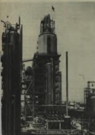
Detalle parcial de la planta de refinería. Se ve el reactor más grande del mundo (distilador) y detalles de la estructura de "desintegración catalítica". Otros detalles de esta planta industrial, o manufacturación de componentes de Turiamo.
